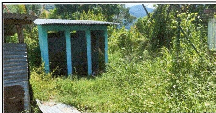
Foto 5: MODULO BAÑO: Los baños presentan deterioramiento
