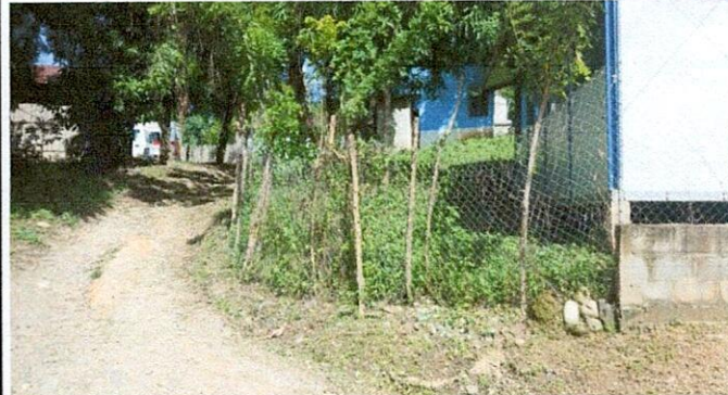
Foto 2: MEJORAMIENTO DE MURO: Las condiciones de seguridad no son buenas
