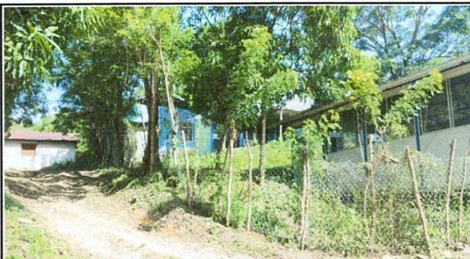
Foto 4: MEJORAMIENTO DE MURO: Se encuentra en mal estado el cerramiento
