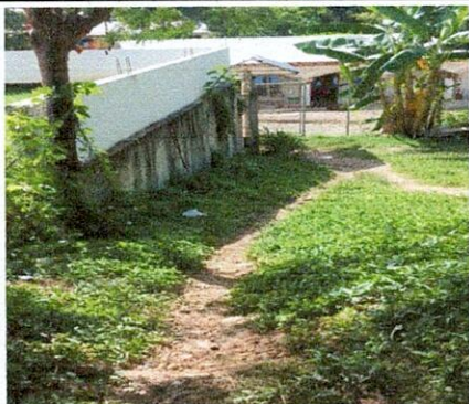
Foto 3: MEJORAMIENTO DE CAMINAMIENTO: Las condiciones de los caminamientos no son adecuadas y los niños resbalan por las lluvias
